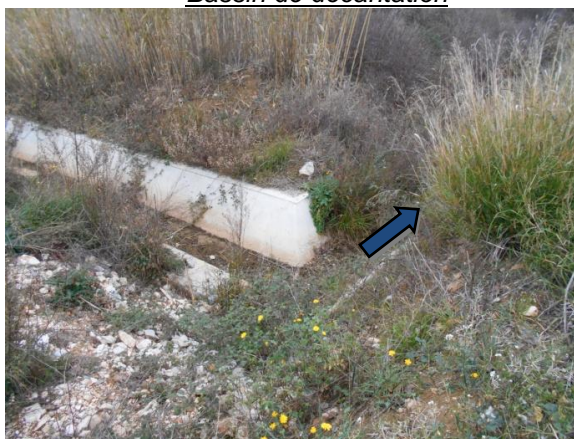
Exutoire vers le milieu naturel (fossé)
