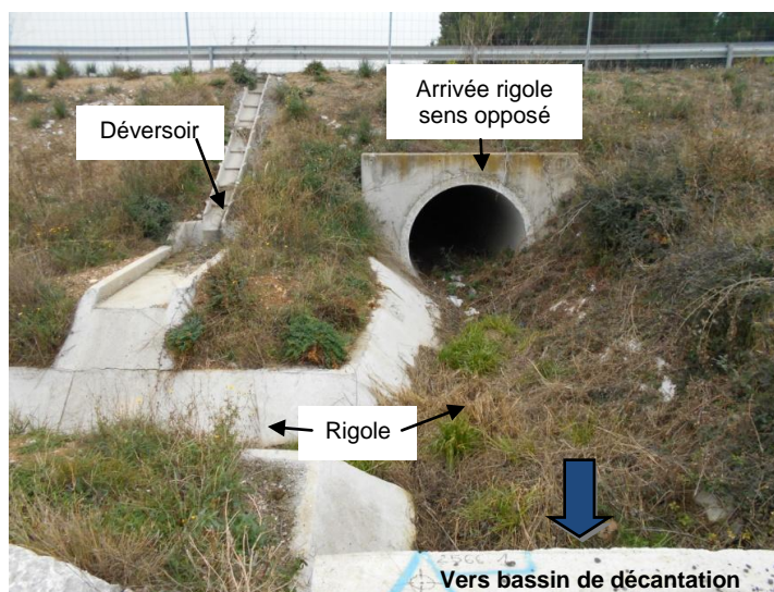
Photo illustrant le déversoir et l'arrivée des eaux récupérées par l'autre voie d'autoroute (Engéo, 2016)
